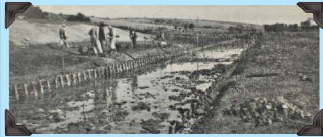
prace przy regulacji Koprzywianki, budowa nowego koryta, lata 30. XX w.; z archiwum Józefa Mjajka
